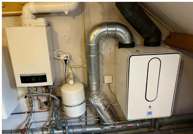
Hybride systeem geplaatst in bestaande cv-installatie.
