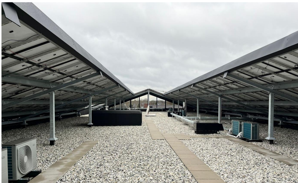
Rijen zonnepanelen op dak complex 'Tonny van Asseldonk' (Doonheide II, Gemert).
